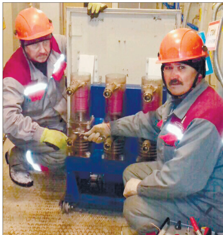
Проверку целостности вакуумных камер выполняют электромонтеры Роберт Лотфуллин и Ильгизар Мурзин
