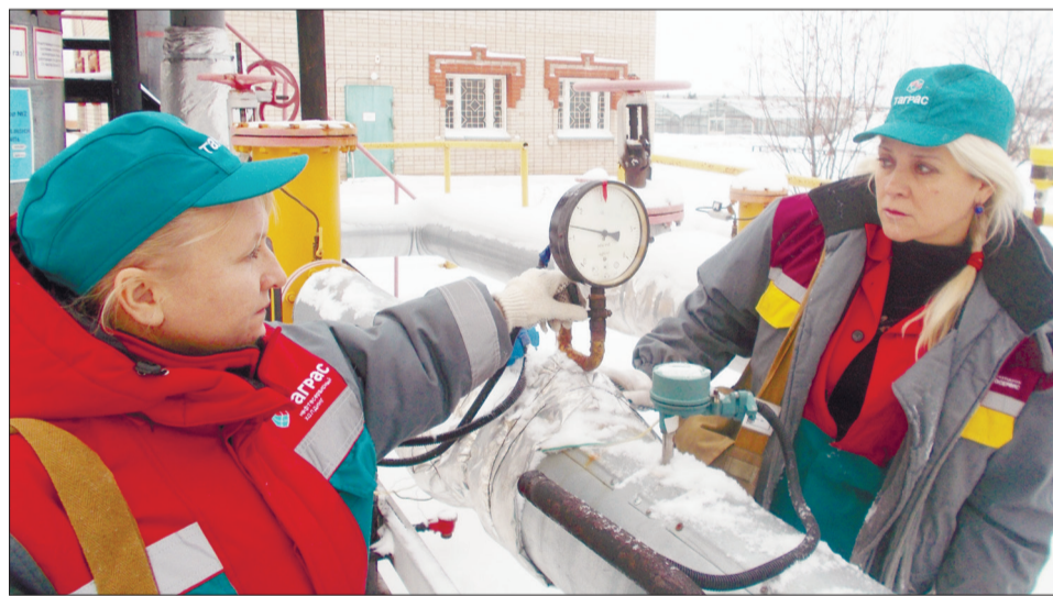
На фото операторы котельной Елховского ТЭЦ: Елена Белозерцева, Светлана Малышева.
